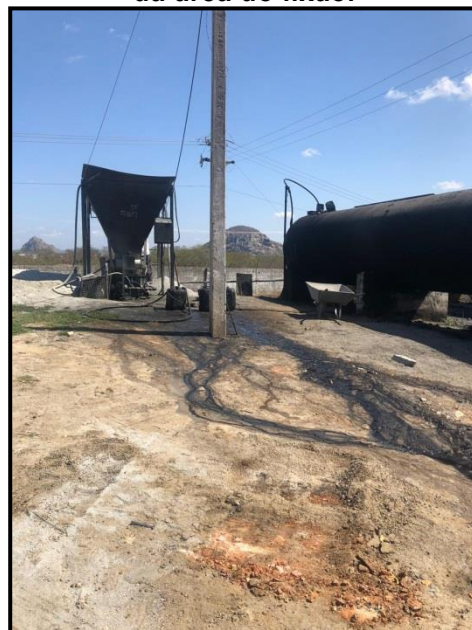
Figura 6 – Usina de asfalto encontrada dentro da área do lixão.
